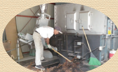
ボイラー管理作業
