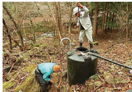
取水口の清掃
